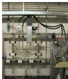
Durch die Molchtechnik erfolgt eine effektive und effiziente Reinigung der Rohrleitungen. Dies spart Reinigungsmittel und Zeit.
