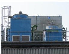
Mit zunehmenden Temperaturen steigt der Wasserverbrauch der Kühltürme durch höhere Verdunstungsraten.
